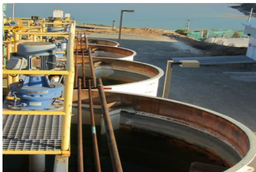
Vattencisterner som utgör en del i vattenreningsprocessen vid gruvan.
